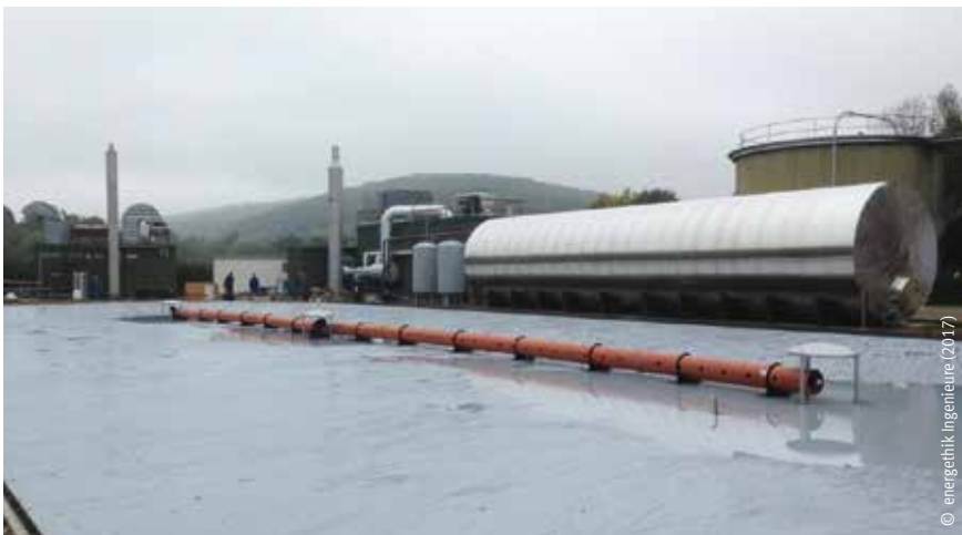
Abb. 30: Satelliten-BHKW-Anlage in Bünste mit einem Wärmespeicher von 300 m 3 Volumen. Auch bei einem liegenden Wärmespeicher ist die Temperaturschichtung kein Problem, wenn Vor- und Rücklauftemperaturen stimmen. Im Vordergrund das Fundament und die Verteilung für den Reingasspeicher mit 11.000 m 3 Atemvolumen.
