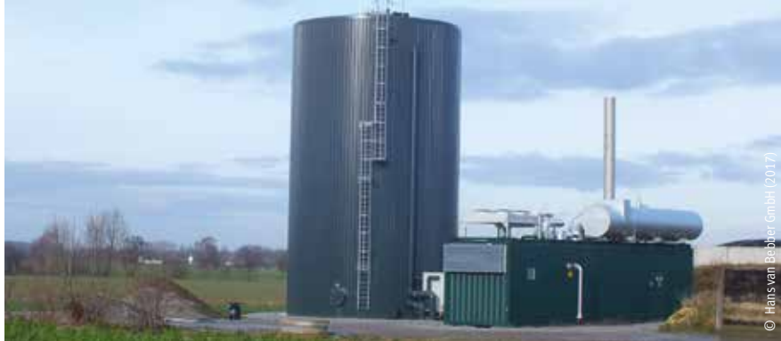
Abb. 25: Flex-BHKW mit Wärmespeicher (Biogasanlage Gut Brockhof): Der Wärmespeicher wird am Ort des höchsten Lastwechsels installiert, also möglichst neben dem BHKW.
