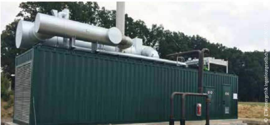
Abb. 26: Flex-BHKW auf Gut Brockhof: Auch ein BHKW mit 2.000 \text{ kW} passt in einen Container und wird fertig konfektioniert angeliefert. Mit einer Laufzeit von etwa 2.500 Stunden pro Jahr wird die technische Laufleistung von 80.000 Betriebsstunden erst in 25 Jahren erreicht.
