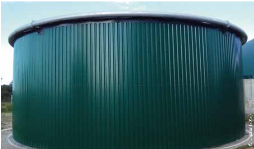
Abb. 28: Großwärmespeicher für das Nahwärmenetz Rixdorf
